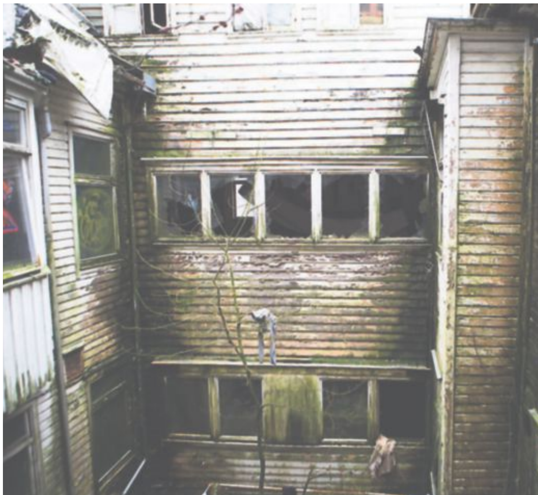
KALFARVEIEN 20: Leder for Robin Hood-huset, Marcos Armano, sendte bekymringsmelding til kommunen 24. mars og at flere av beboerne har en alvorlig smittsom sykdom (hepatitt).
